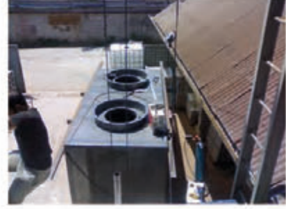
Zemin Üzeri Atık Yağ Tankı Above Ground Waste Oil Tank
